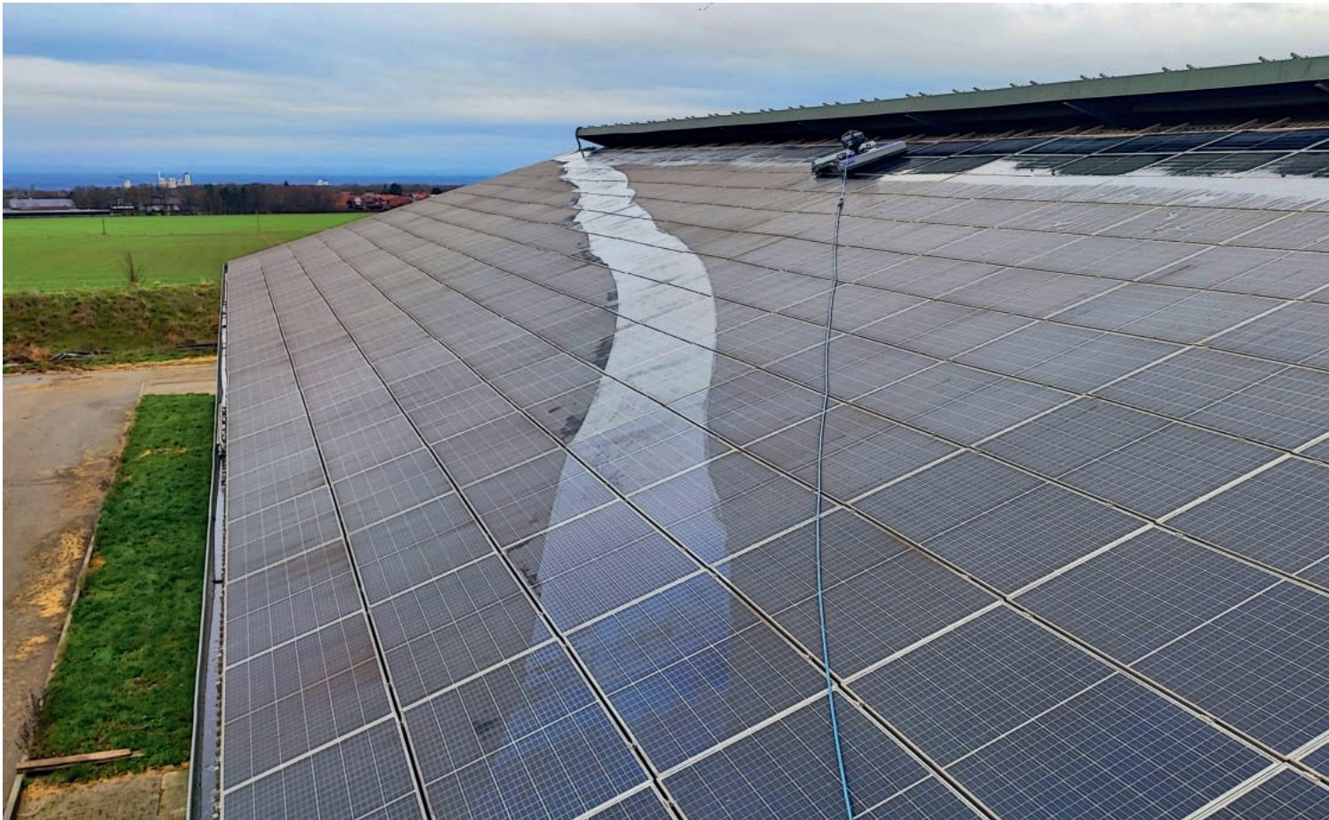
Landwirt Stefan Hüser reinigt seine PV-Anlage im Bereich der Strohhaltung zweimal pro Jahr.
