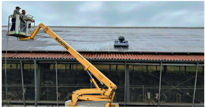
Auf PV-Anlagen über Tierställen bilden sich oft Flechten.
